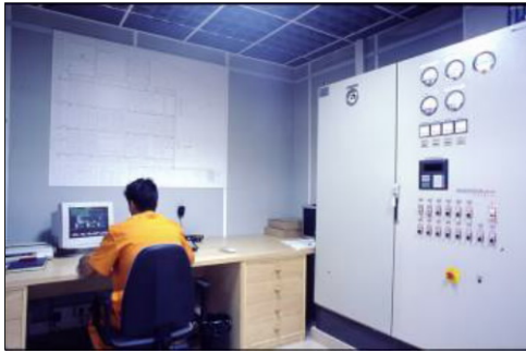
Salle de contrôle
