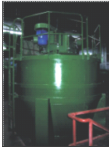
Cyclone d'arrivée des déchets (un part type de déchets)
