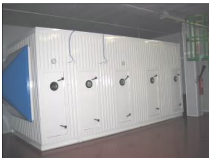
Salle des filtres
